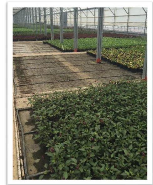
Tuberías de riego en viveros de producción de plantas ornamentales leñosas en UK.
