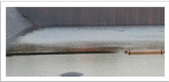
Figura 1 Las burbujas indican la presencia de agua o aire debajo de la lámina (o revestimiento). Si se forman burbujas más grandes, esto puede llevar a la ruptura de la lámina. El agua debajo de la lámina también puede dañar los diques (Fuente: PSKW).
